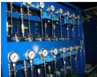
Photographie d'une servitude pneumatique
